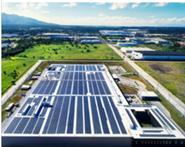
菲律宾八打雁 4.77MW 屋顶光伏电站
