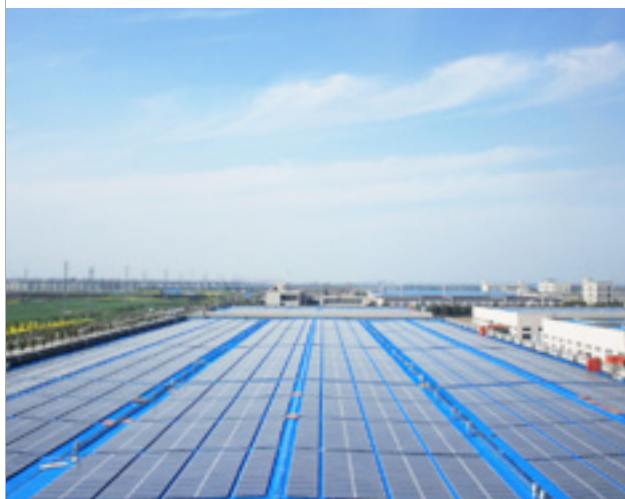
浙江嘉兴 11MW 屋顶光伏电站
