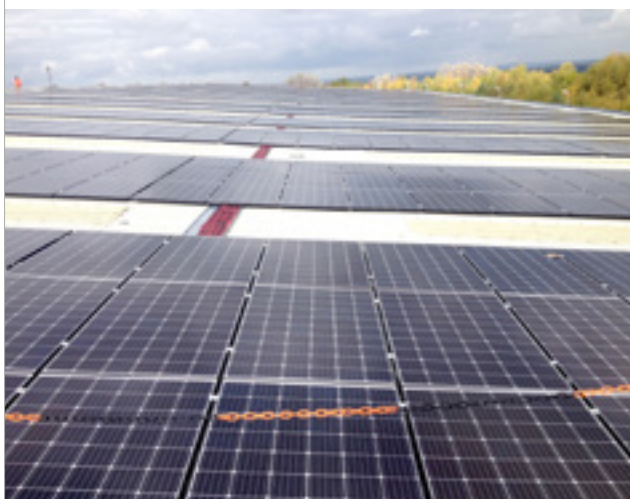
英国 Lyreco 3.8MW 屋顶光伏电站
