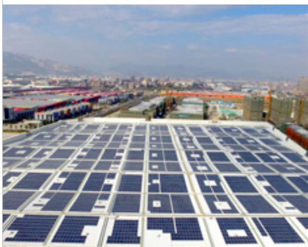
福建泉州 100MW 屋顶光伏电站（项目集群）
