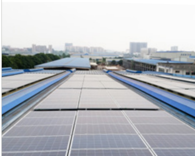
福建厦门 22MW 屋顶光伏电站
