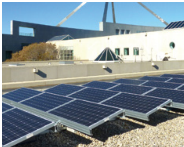
澳洲国会屋顶光伏项目
