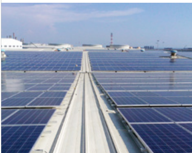
海南儋州 24MW 屋顶光伏电站
