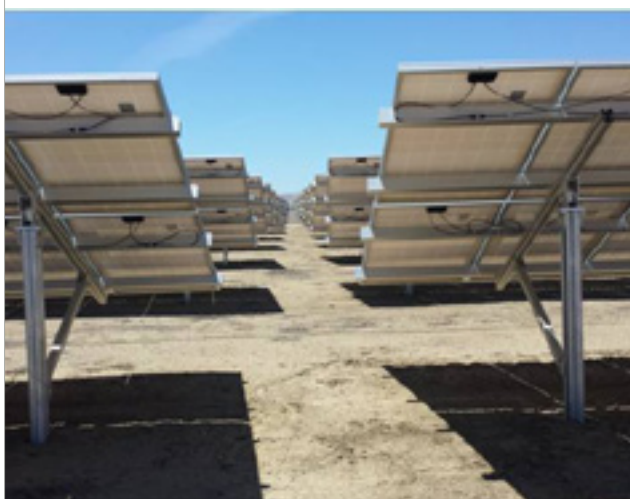
美国加州 38.7MW 地面光伏电站
