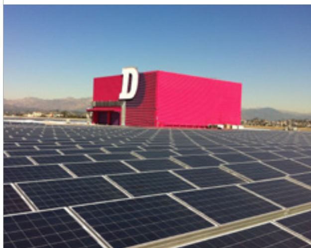
美国 Dependable 屋顶光伏电站
