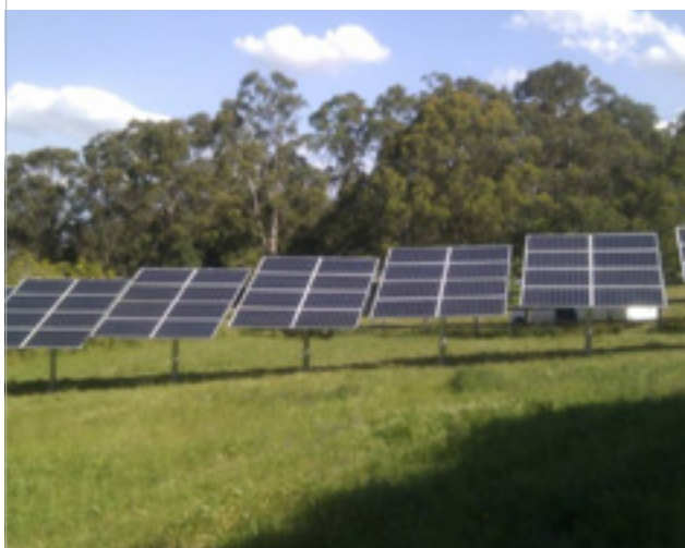
维多利亚地面光伏电站
