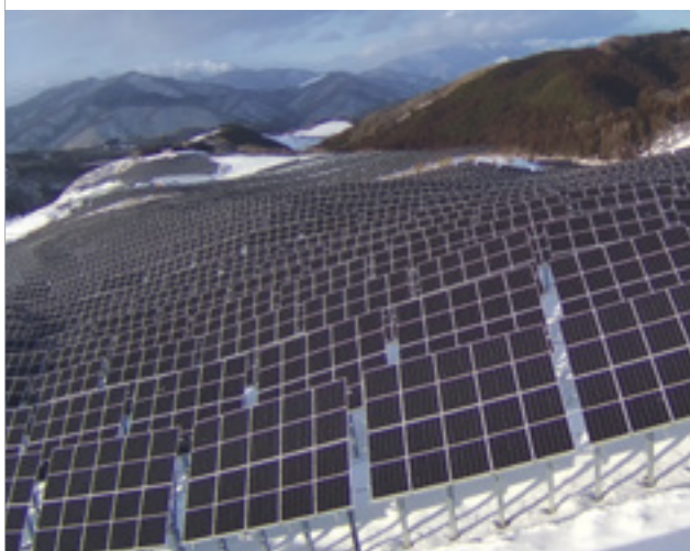
日本·岐阜県高山市荘川町 30.8MW 地面光伏电站
